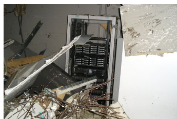
浸水したサーバーラック
